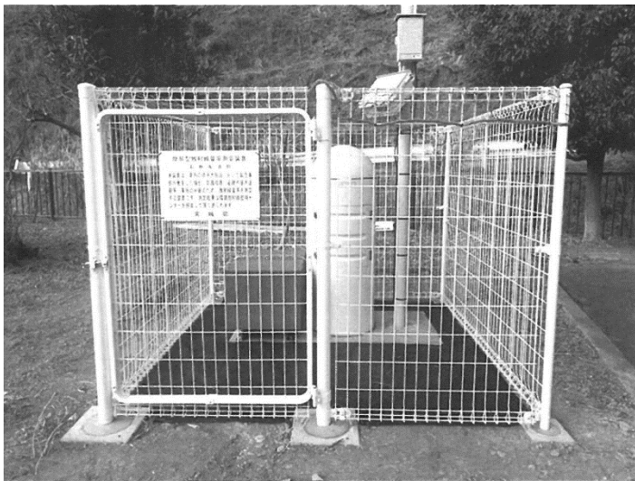
設置状況の写真 (宮城県水産技術総合センター内)
