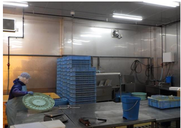
HACCP ハード事業 加工場壁面修繕
