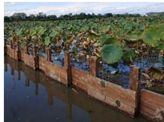
沼内に設置された様子
