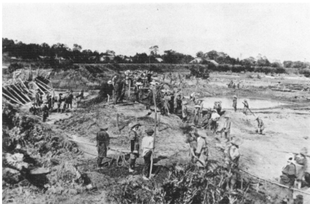
鳴瀬川下伊場野村志田橋下流破堤
