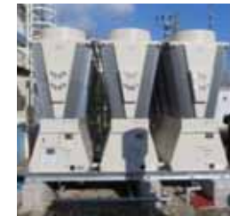
高効率空調機 (食品製造工場への設置)
