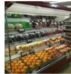
高効率ショーケース (スーパーへの設置)
