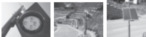
写真(女川町設置のハイブリッドポール)
