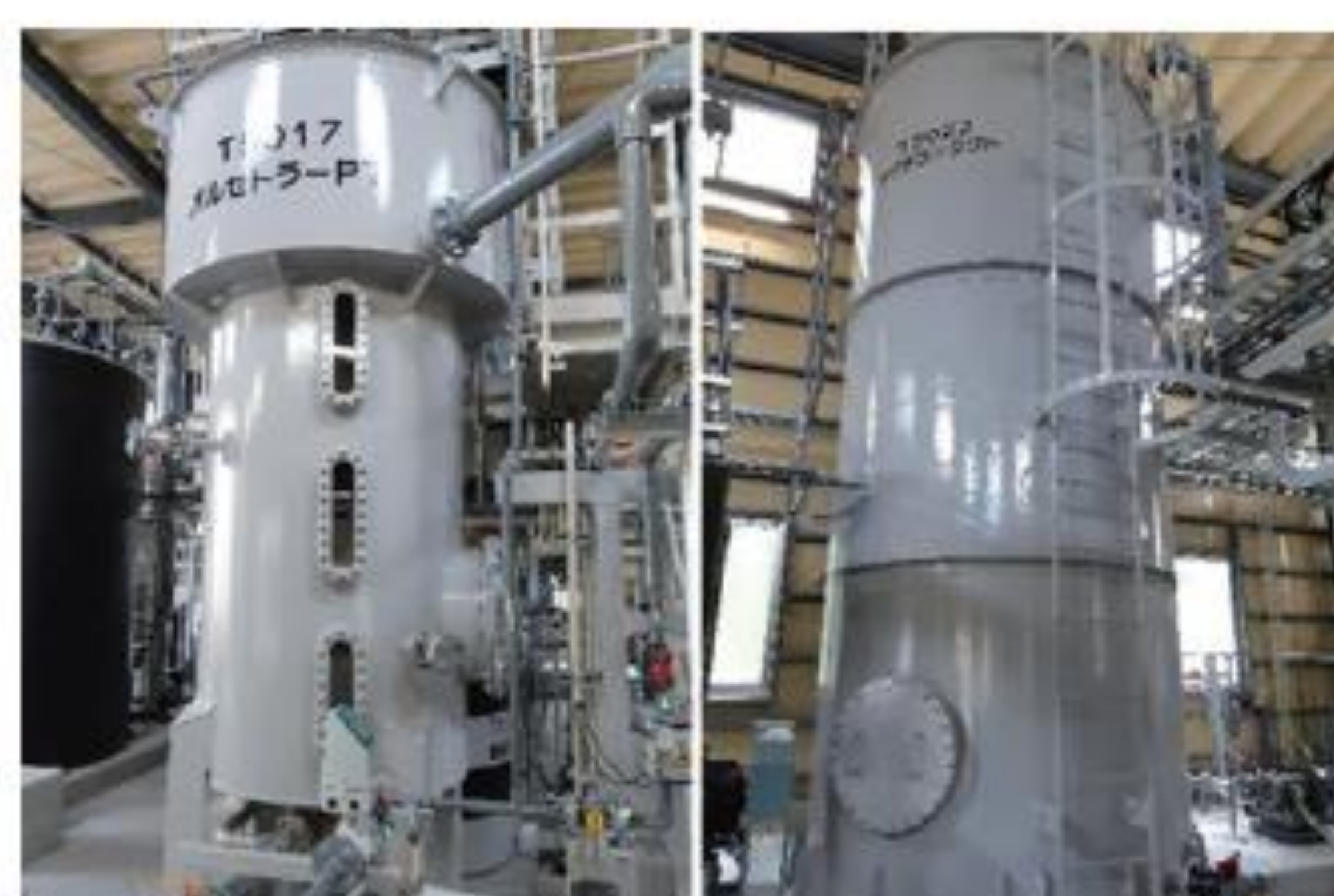
▲高速凝集沈殿槽＋流動床式生物処理
