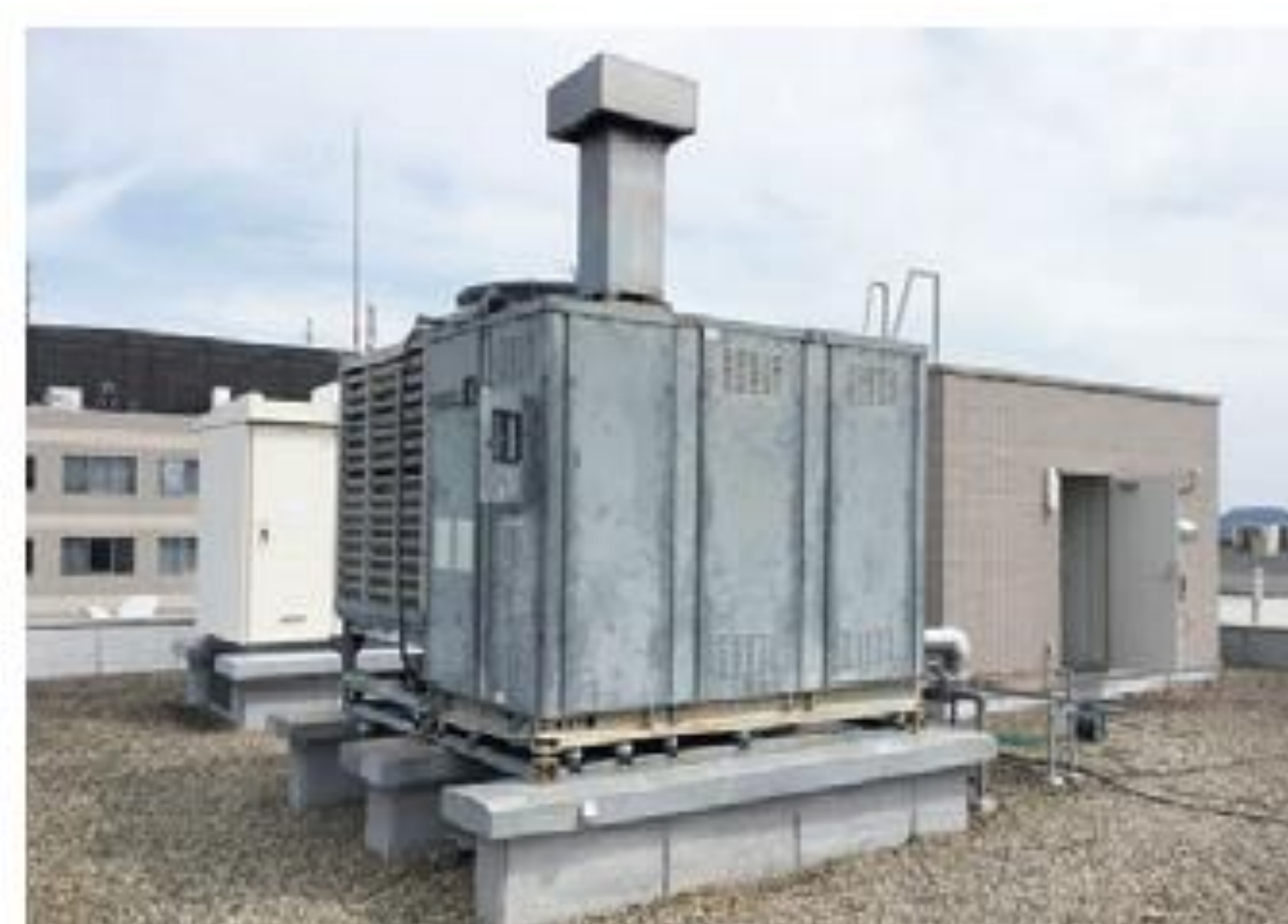
▲吸収式冷凍機（更新前）
