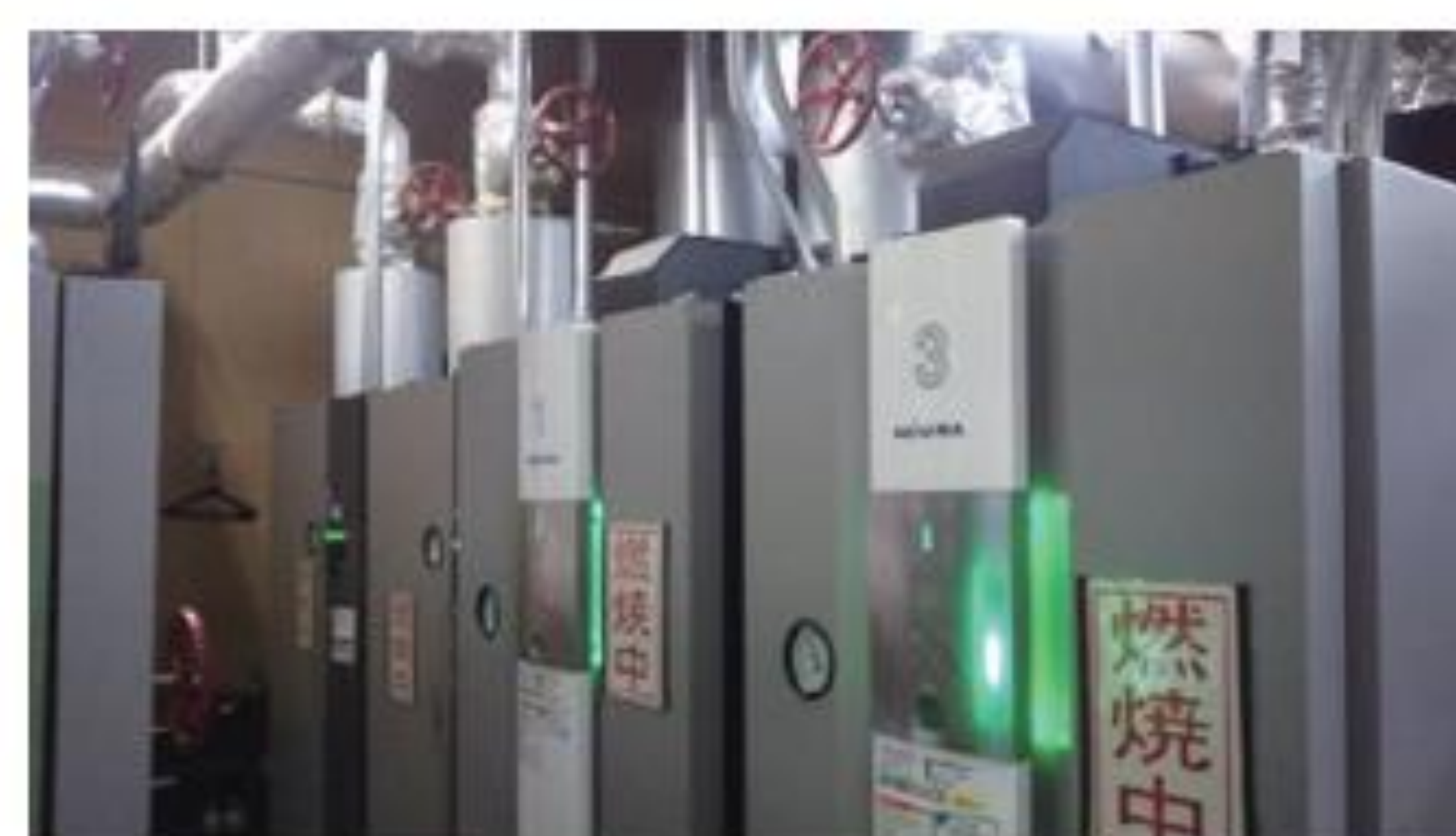
▲手前2台 新規導入 ガス炊きボイラー
