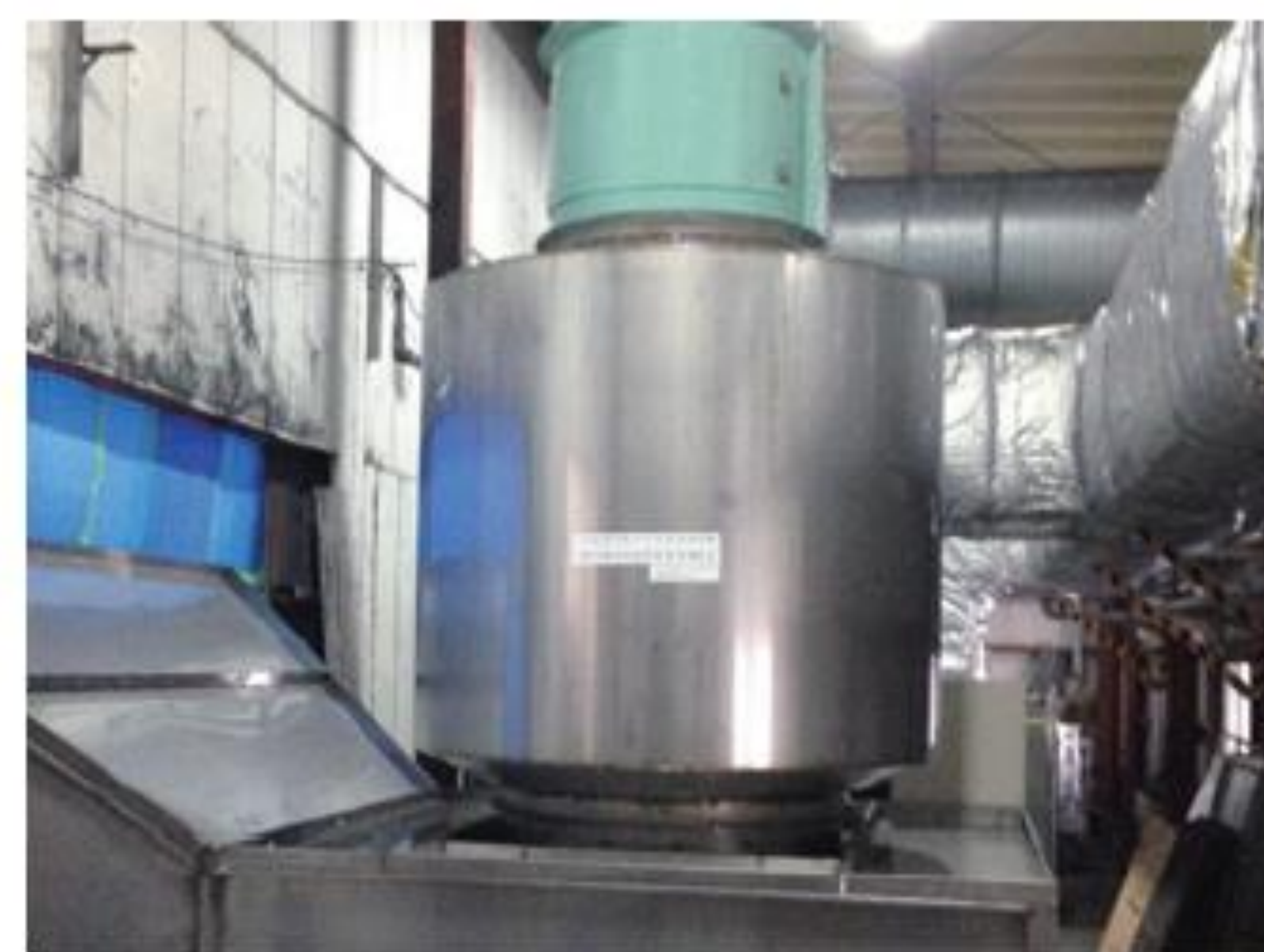
▲導入設備2 塗装排気処理装置
