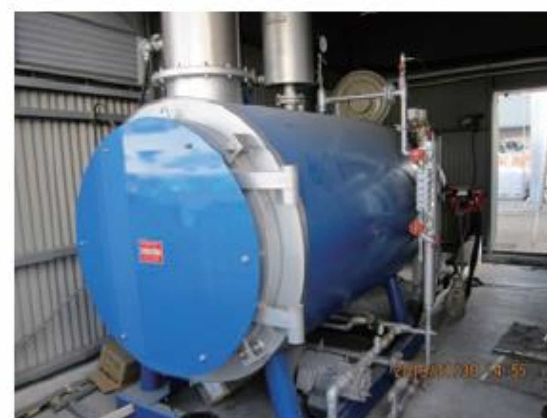
▲再生燃料専用ボイラー
