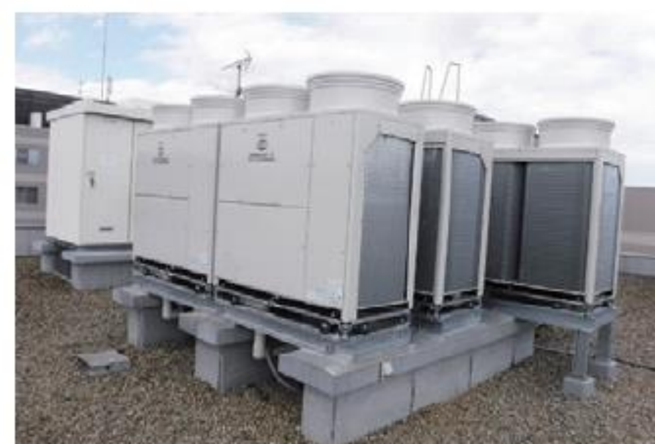
▲1、2、3階系統ヒートポンプ（更新後） エアコンの室外機。既存基礎を利用。
