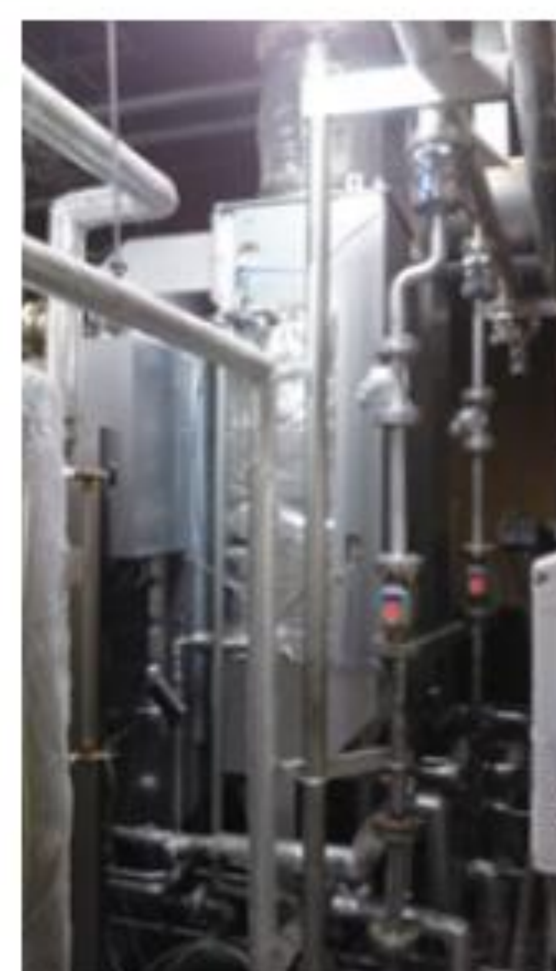
▲ガスボイラー (エコマイザ)
