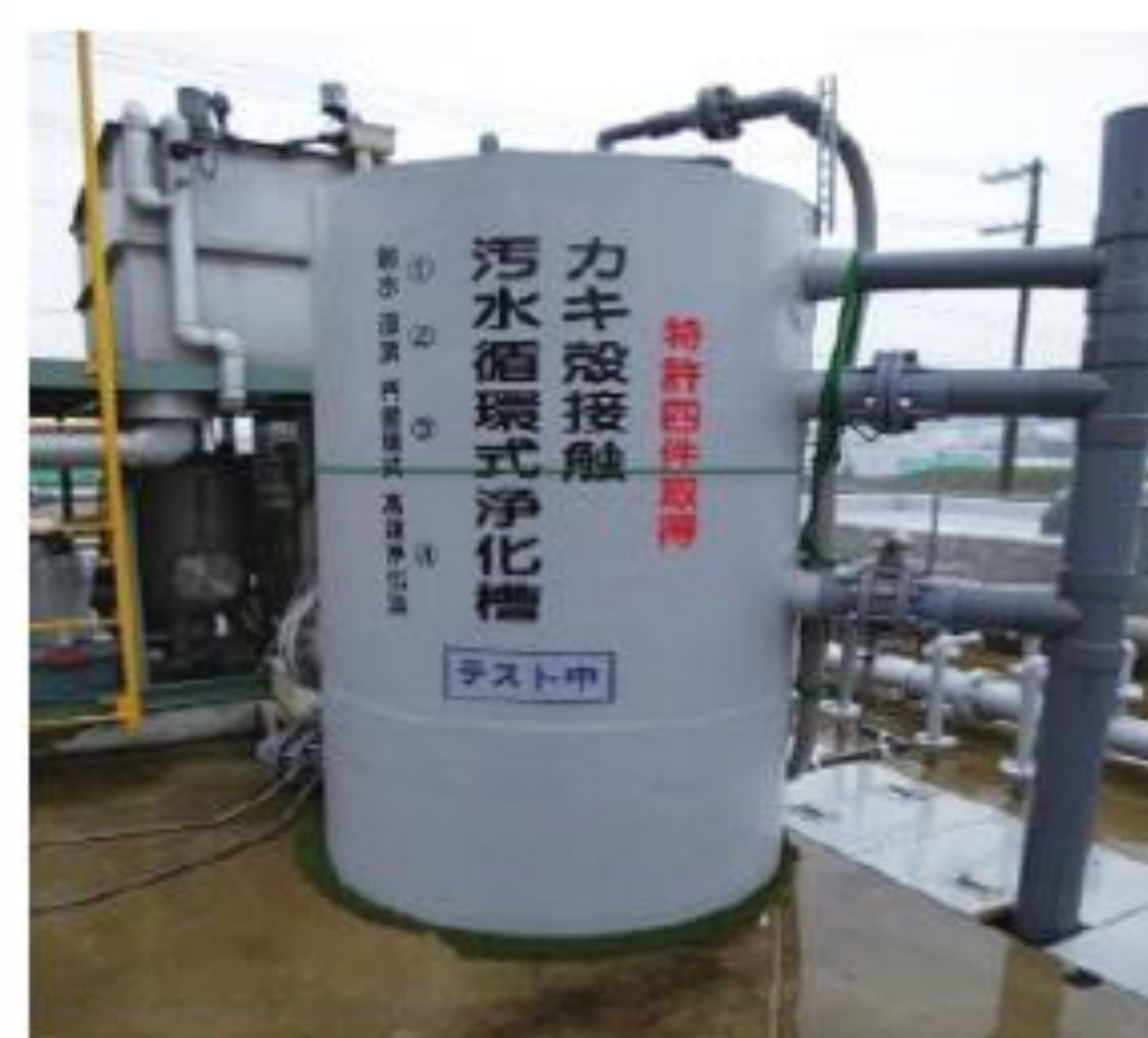
▲カキの殻をろ材を利用した汚排水浄化設備
