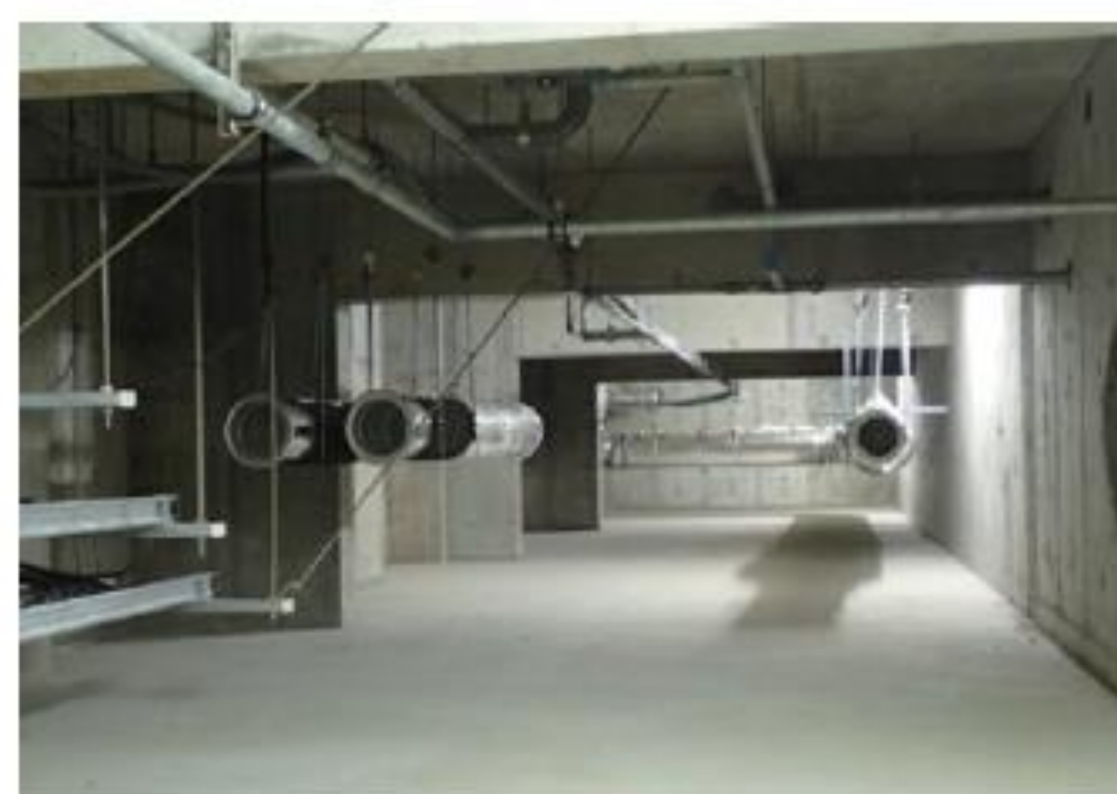
▲地下ピット(ジオ・チューブ)内の状況
