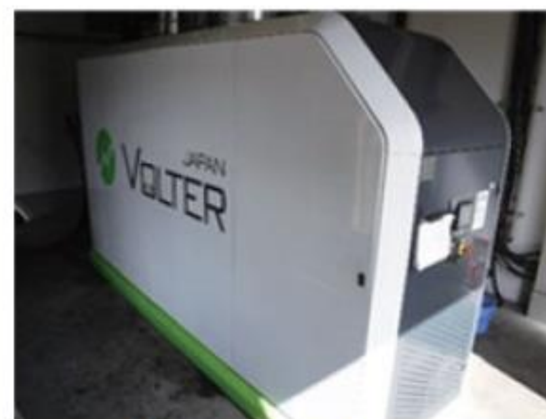
▲発電装置 (Volter40) (川崎工場)
