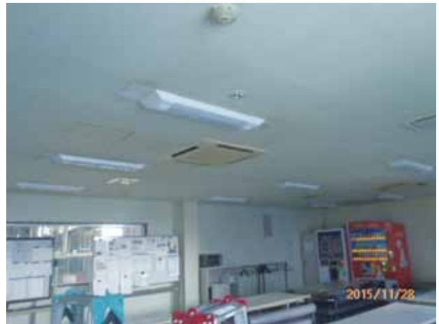
▲工事後の照明
