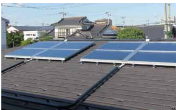
▲設置した設備の様子
