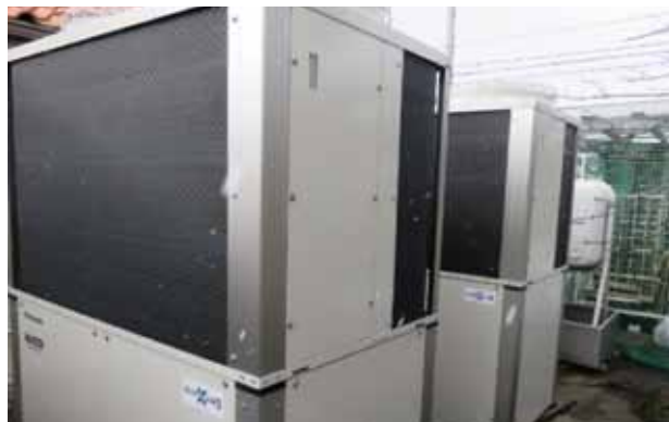
▲導入設備の例 (高効率空調)
