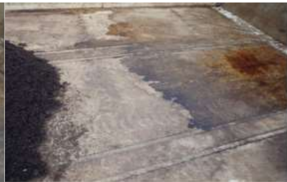
図4 試験期間中の床面(試験区):堆肥に結露水が戻らない
