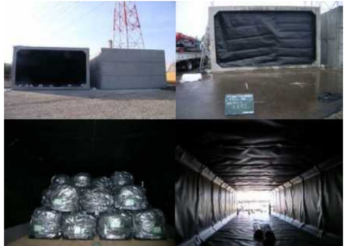
焼却灰をフレキシブルコンテナに詰めボックスカルバート内に保管
