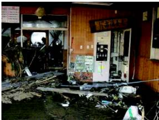
被災後の校舎 (山元町立山下第二小学校)
