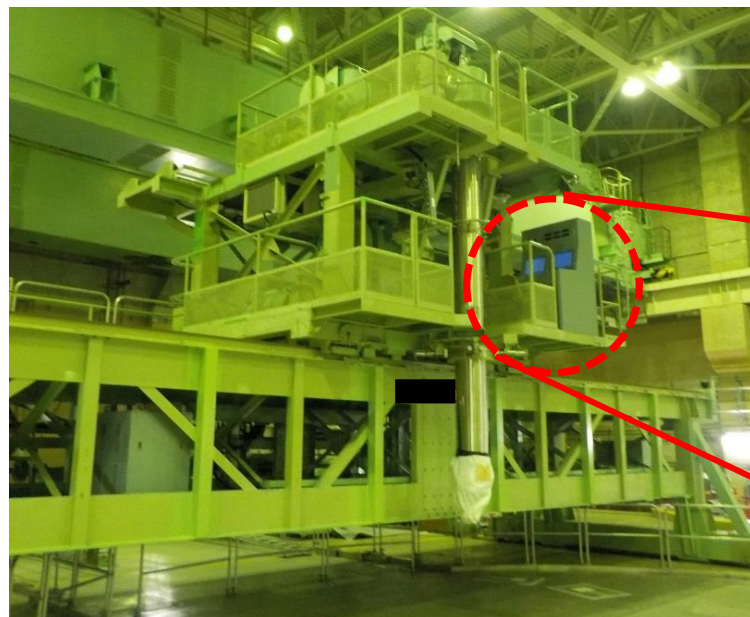
燃料交換機 全景写真
