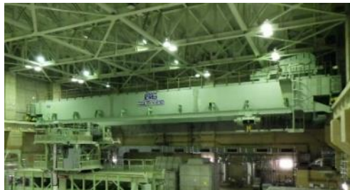
天井クレーン全景（写真）
