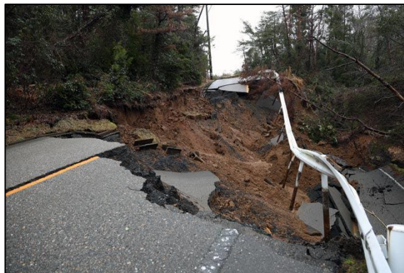
石川県七尾市の 道路被災状況
