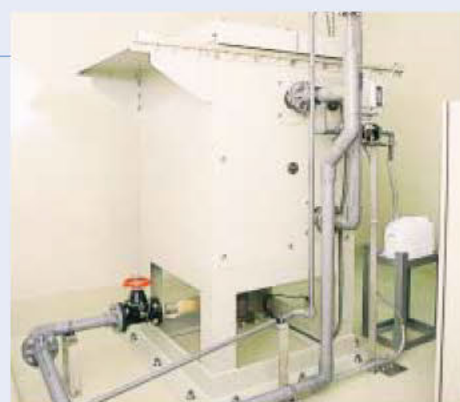
放水口モニター (2号機)
