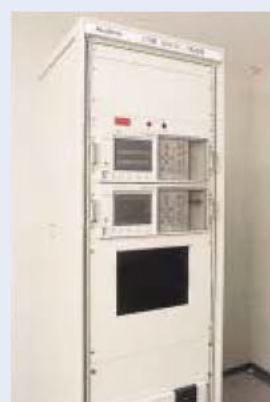
放水口モニター監視盤 (2号機)
