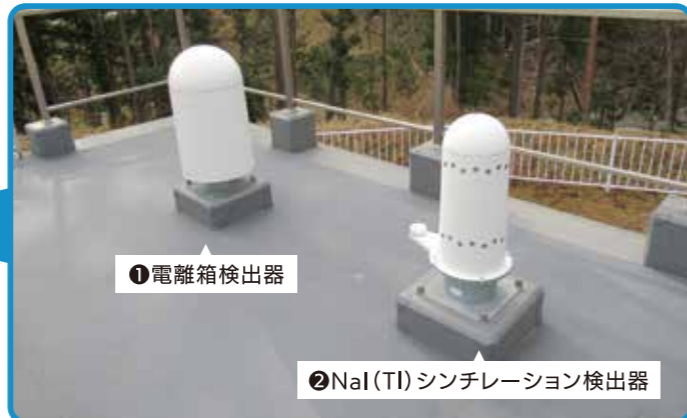
屋上に設置された測定機器
